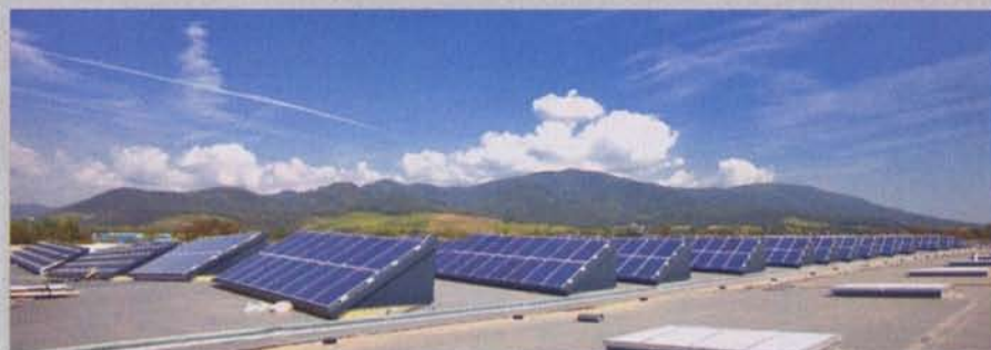
Projet en toiture d'un supermarché Leclerc à Cernay - Construction par Spie Est avec des modules Upsolar.
